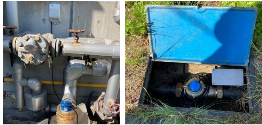
正起ガス株式会社様(製薬工場)
